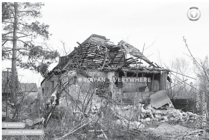
Разрушенный дом в Новоалександровке
